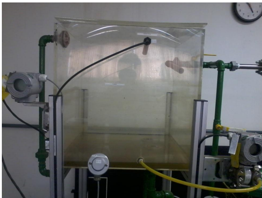
Figura 4.1 - Transmissores do tanque de abastecimento.
