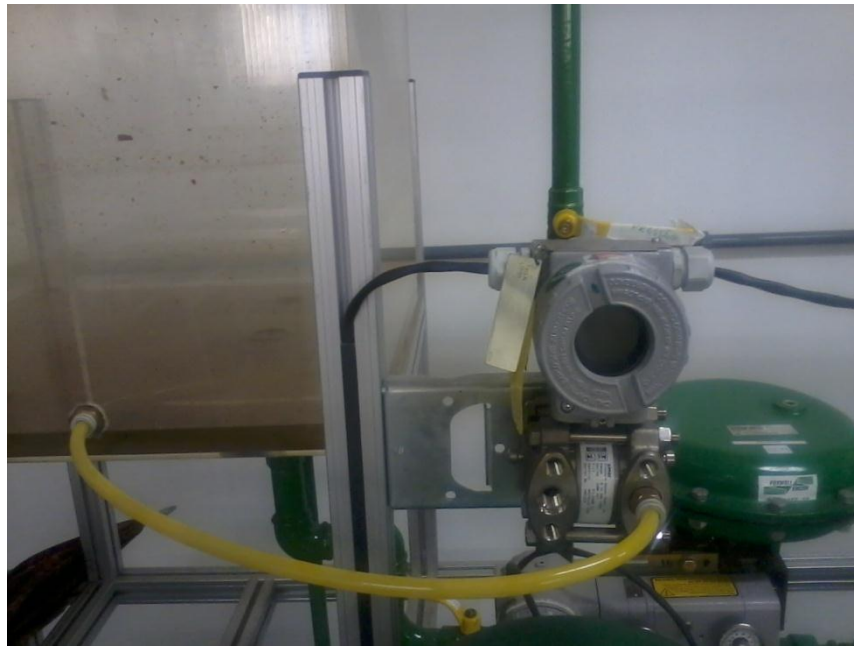
Figura 3.7 - Transmissor para medição do nível do tanque de abastecimento.
