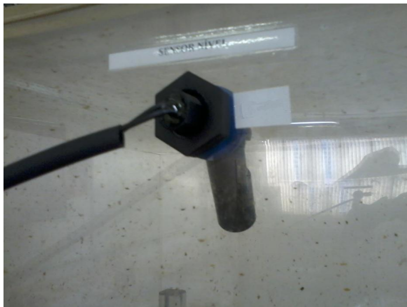
Figura 3.6 - Chave de nível do tanque de abastecimento.
