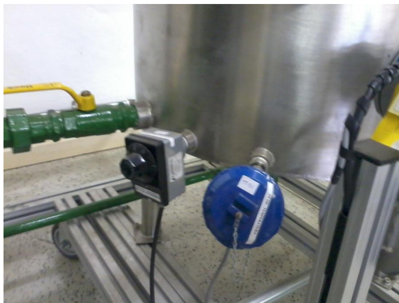
Figura 3.8 - Termostato e pt 100 do vaso de pressão.
