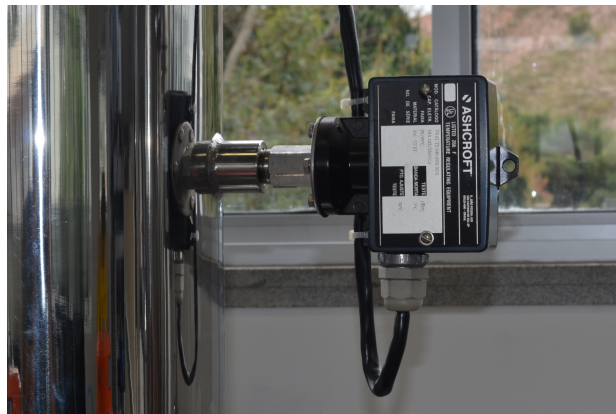
Figura 65 – Regulador de temperatura e duas resistências de imersão
