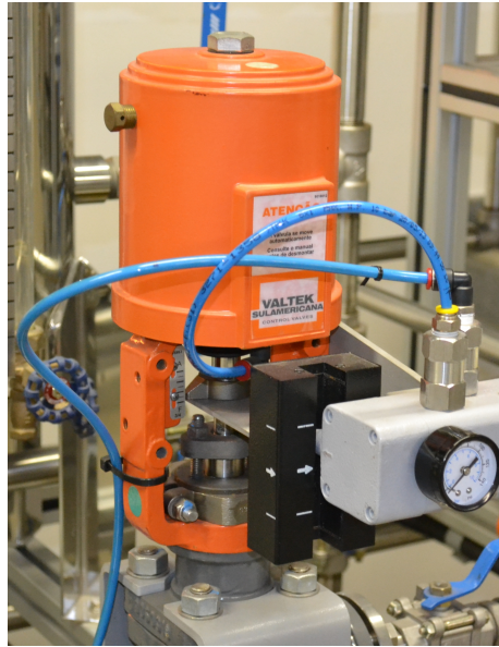
Figura 64 – Válvula de controle
