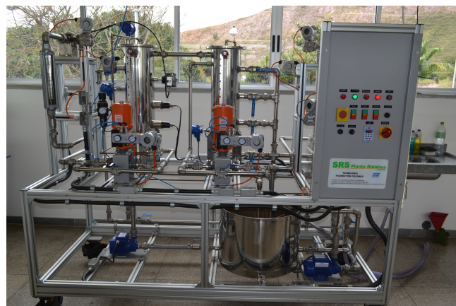
Figura 51 – Estrutura física planta SMAR PD3 Foundation Fieldbus
