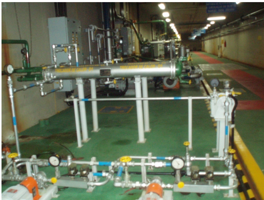
FIGURA 25: SISTEMA DE LUBRIFICAÇÃO DO MANCAL GUIA SUPERIOR (TROCADOR DE CALOR NO CENTRO DA FOTO)
