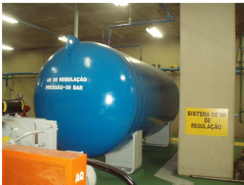
FIGURA 36: TANQUE DE AR PRESSURIZADO DE REGULAÇÃO
