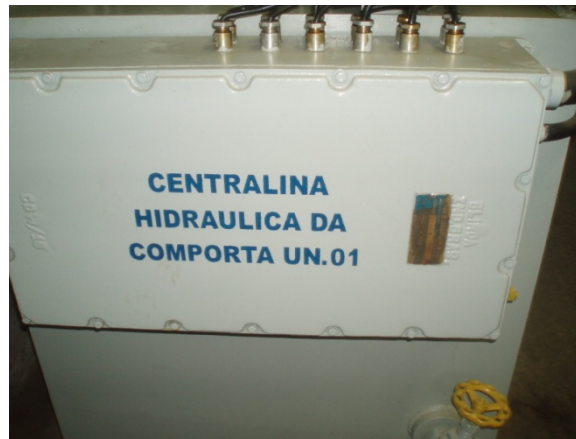
FIGURA 37: TANQUE DE ÓLEO DA CENTALINA HIDRÁULICA
