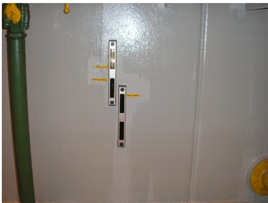
FIGURA 13: MONITOR E NÍVEL DE ÓLEO NO TANQUE RETANGULAR DE ÓLEO
