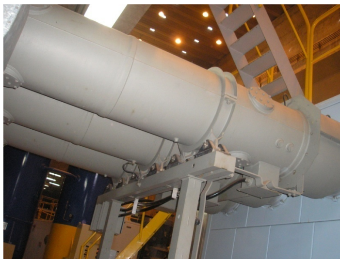
FIGURA 17: BARRAMENTO DE COBRE PROTEGIDO COM AR SECO PRESSURIZADO
