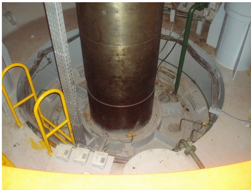
FIGURA 16: PARTE INFERIOR DO EIXO DA PARTE EXPOSTA DO EIXO DE TURBINA. ALGUMAS VEZES A ÁGUA INVADIRIA O COMPARTIMENTO CILÍNDRICO VISTO NA PARTE INFERIOR DA FOTO.
