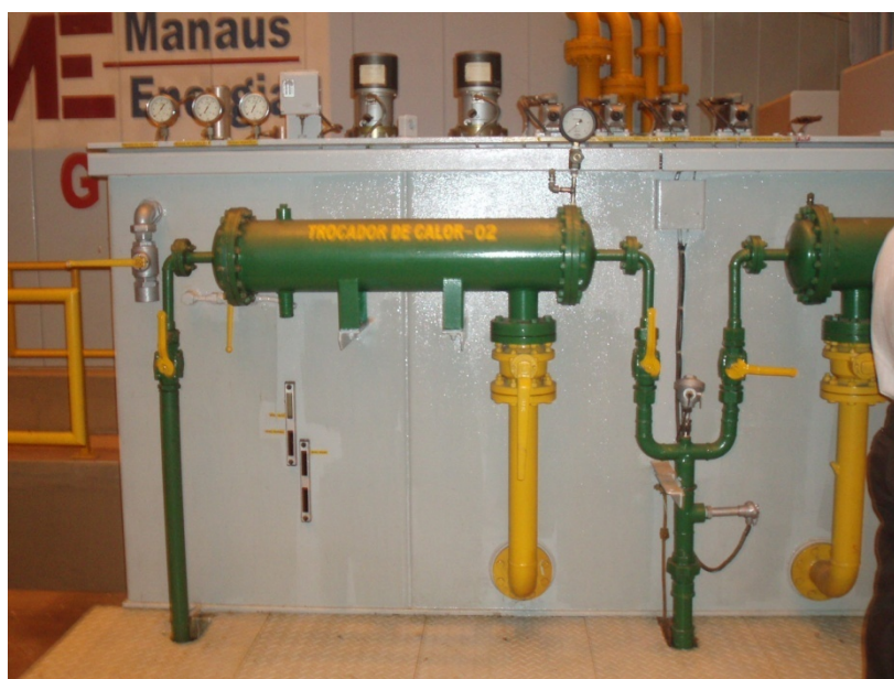
FIGURA 11: TROCADOR DE CALOR INSTALADO NO TANQUE RETANGULAR.
