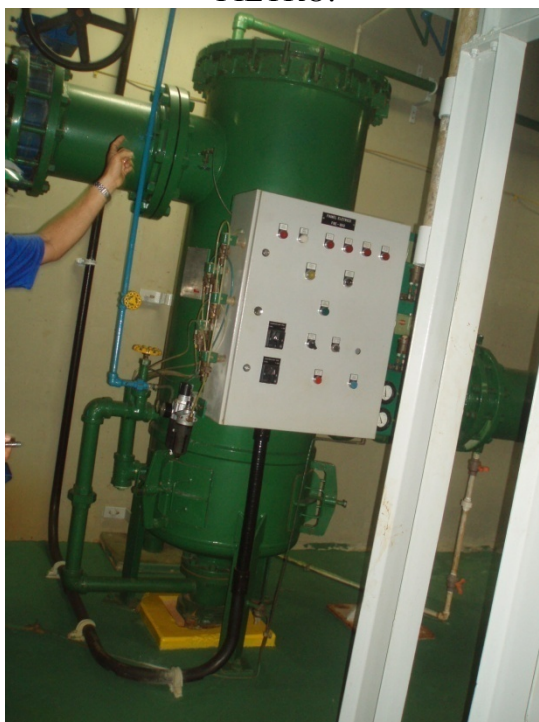
FIGURA 19: FILTRO PARA RETER AS IMPUREZAS DA ÁGUA DA REPRESA.
