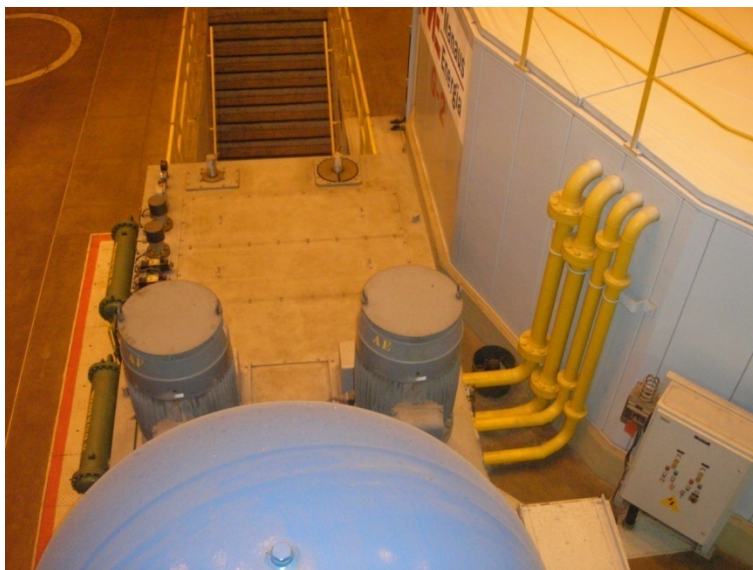
FIGURA 8: TANQUE DE ÓLEO EM PRESSÃO E DUAS MOTOBOMBAS PARA ACIONAMENTO DOS ÂNGULOS DAS PÁS DO HELICE DA TURBINA
