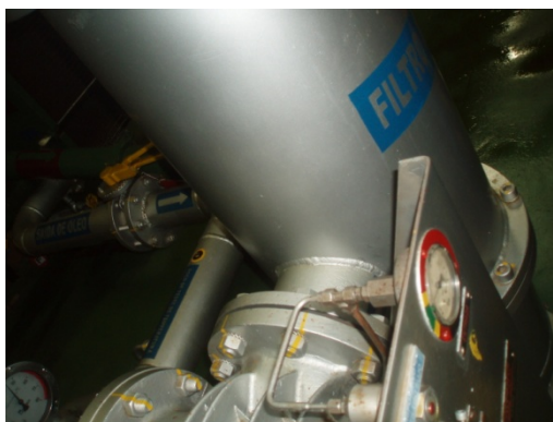
FIGURA 30: MEDIDOR DE PRESSÃO DO ÓLEO NA ENTRADA DO FILTRO
