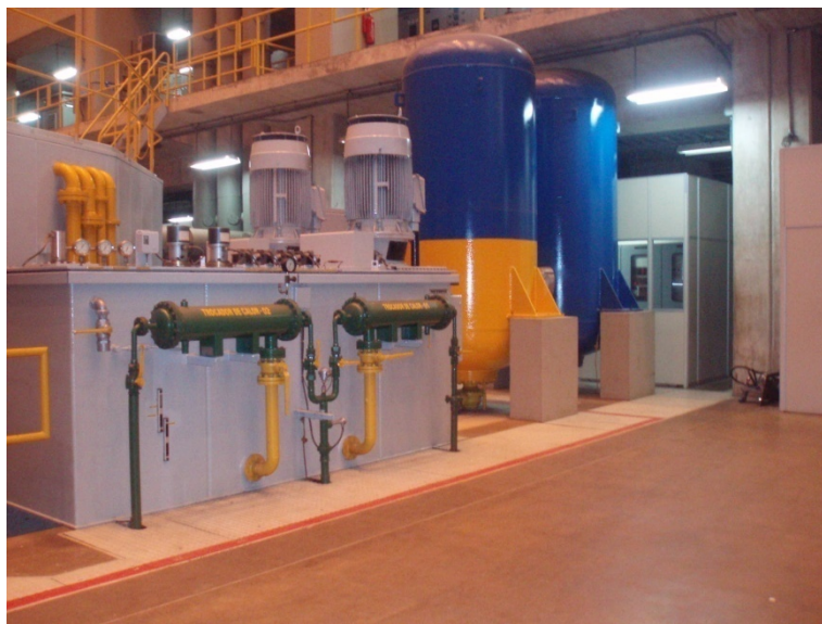
FIGURA 10 : TANQUE RETANGULAR DE ÓLEO COM DUAS BOMBAS HIDRÁULICAS E TROCADOR DE CALOR.
