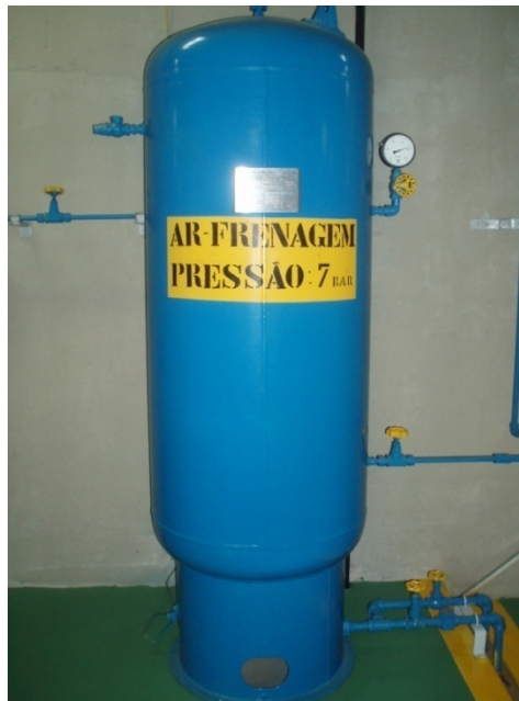
FIGURA 14: TANQUE DE AR PRESSURIZADO PARA SISTEMA DE FRENAGEM DA TURBINA E INDICADOR DE PRESSÃO.
