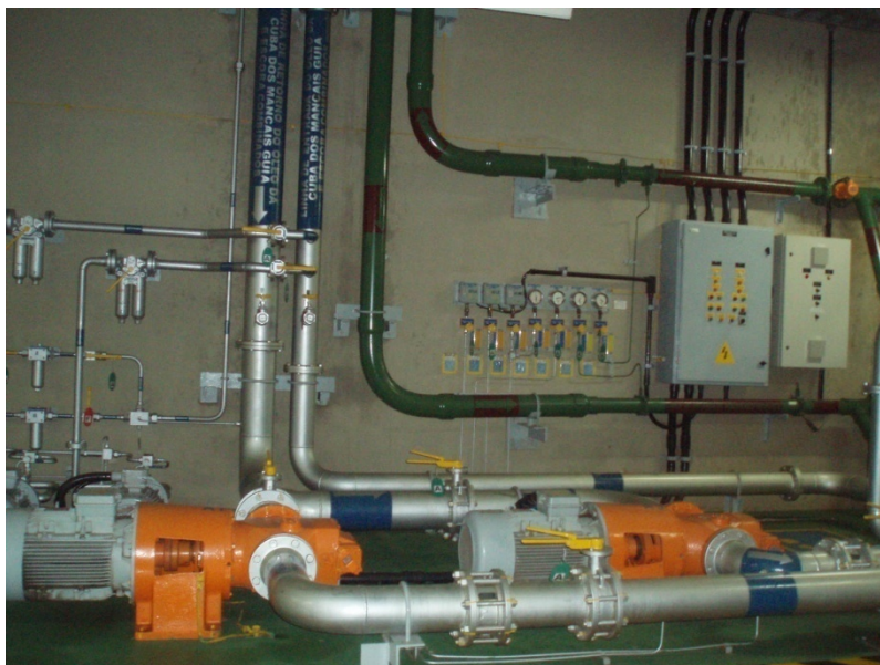
FIGURA 27: BOMBAS DE ÓLEO PARA LUBRIFICAÇÃO DO MANCAL GUIA E DE ESCORA COMBINADOS.
