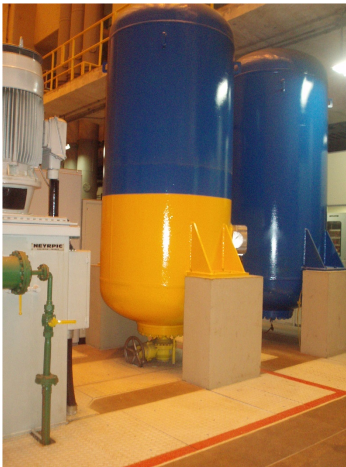
FIGURA 6: DOIS TANQUES CILINDRICOS SENDO UM DELES CONTENDO ÓLEO COM COLCHÃO DE AR (PINTADO DE AZUL E AMARELO) E UM OUTRO SOMENTE DE AR PRESSURIZADO.
