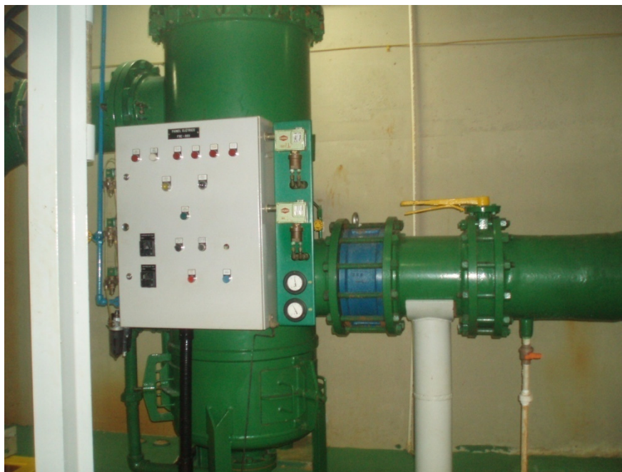
FIGURA 20: DUTO DE SAIDA DO FILTRO. PODE-SE VER OS DOIS INDICADORES DE PRESSÃO AO LADO DO PAINEL ELÉTRICO.
