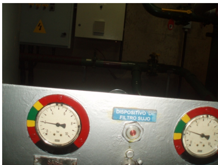
FIGURA 31: MEDIDORES DE PRESSÃO DO ÓLEO NA ENTRADA E SAIDA DO FILTRO (A ESQUERDA É DE SAIDA)
