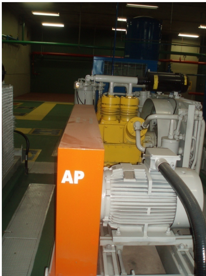
FIGURA 35: COMPRESSOR DE REGULAÇÃO
