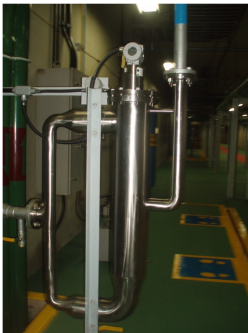
FIGURA 22: TRANSMISSOR INSTALADO NO MEDIDOR DE DENSIDADE DO ÓLEO.
