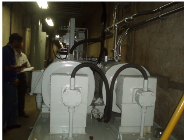
FIGURA 38: BOMBA DE ÓLEO DA CENTRALINA HIDRÁULICA
