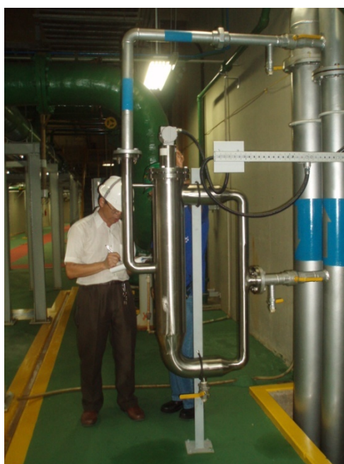
FIGURA 21: MEDIDOR DE DENSIDADE DO ÓLEO.
