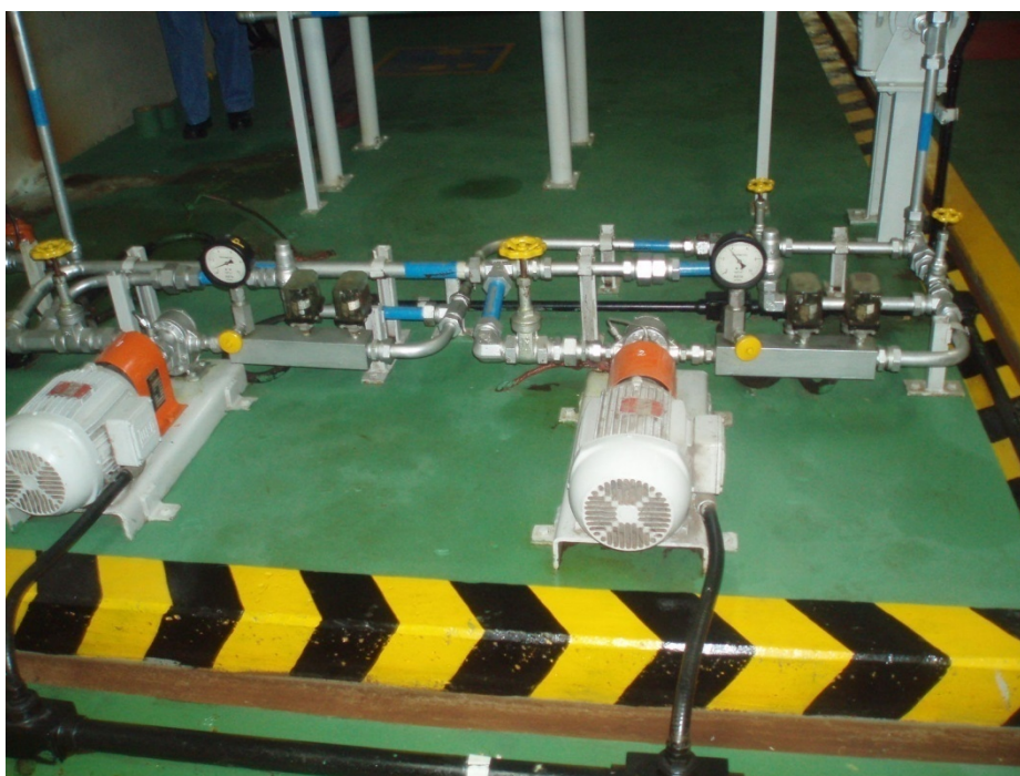
FIGURA 26: BOMBAS HIDRÁULICAS PARA CIRCULAÇÃO DO ÓLEO DE LUBRIFICAÇÃO DO MANCAL GUIA SUPERIOR.
