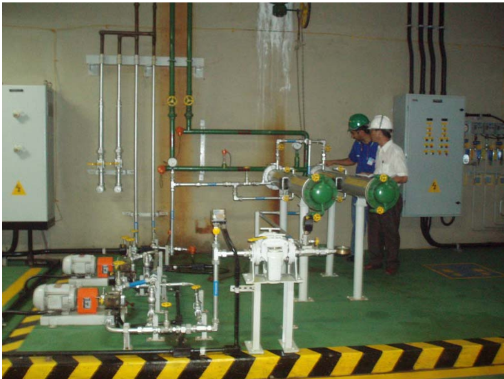
FIGURA 24: SISTEMA DE CIRCULAÇÃO DE ÓLEO PARA LUBRIFICAÇÃO DO MANCAU GUIA SUPERIOR DO GERADOR.
