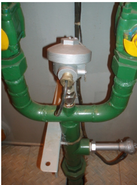
FIGURA 12: SENSOR DE TEMPERATURA INSTALADO ENTRE OS TROCADORES DE CALOR.
