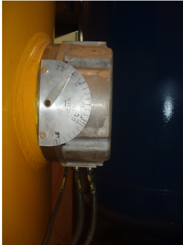
FIGURA 7: INDICADOR DE NÍVEL DE ÓLEO INSTALADO NA PARTE LATERAL DO TANQUE CILINDRICO DE ÓLEO COM COLCHÃO DE AR.
