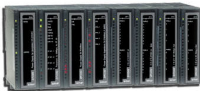
Vista geral do DF65 + Módulos IO's
