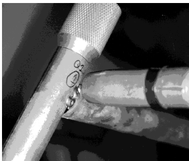
Figura 7: Ponto atingido pela tocha de soldagem.
