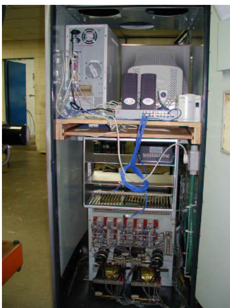
Figura 14: Vista traseira do gabinete do controlador.
