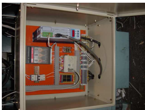
Figura 7 – Novo sistema de controle utilizando CLP
