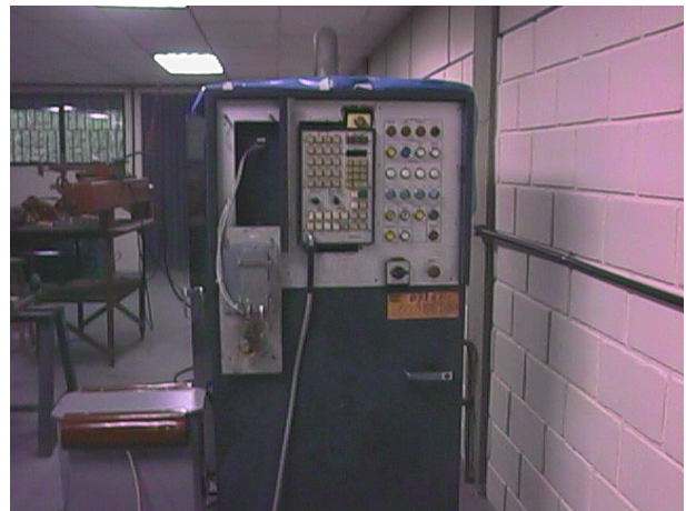
Figura 10: Controlador do Robô ASEA IRB6 S2
